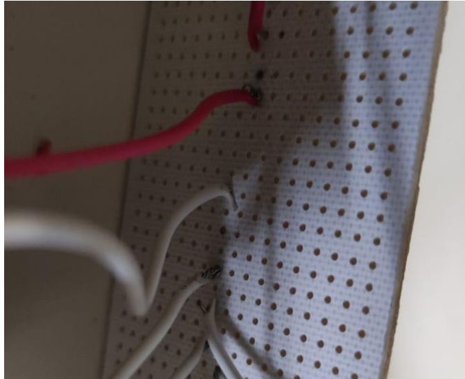
Figura 47.- Placa fenólica utilizada para el circuito.
