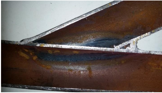
Ilustración 82 muestra de soldadura
