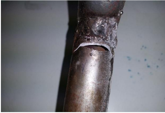
Ilustración 77 muestra de soldadura
